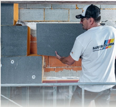
Im Sockelbereich wurde das mit am besten dämmende Austrotherm XPS® Premium P eingesetzt [ \lambda = 0,027 \text{ W/(mK)} ].
