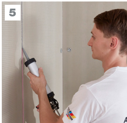
5 Fugen verschließen Die Fugen mit demselben systemgeprüften Dichtstoff verschließen bzw. nachverfüllen, anschließend abziehen und glätten.
